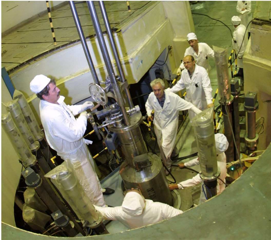
Активная зона ИБР-2. Это бак емкостью 22 л, в который помещено топливо – двуокись плутония. Бак загружается в корпус реактора.
